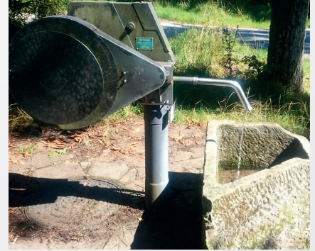
Wasserwerk Illingen, Deutschland
